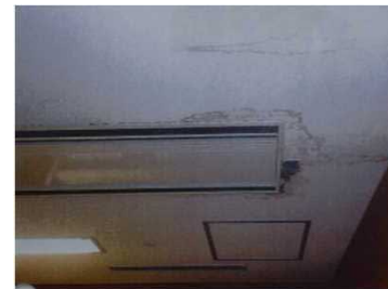
【空調設備(ファンコイル)】
