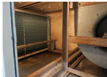
【空調設備(送風機)】
